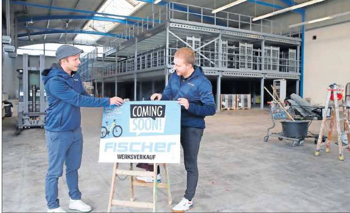
Noch ist es eine Baustelle: Stefan Molder (links) und Christian Rüffel im neuen Fischer-Gebäude. Die Bühnenanlage (hinten im Bild) wird künftig als Lager für E-Bikes dienen. FOTO: IVERSEN
